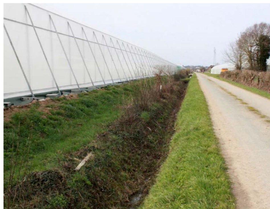
4 Une trame de l'eau sous pression : déchaussement des fondations...
